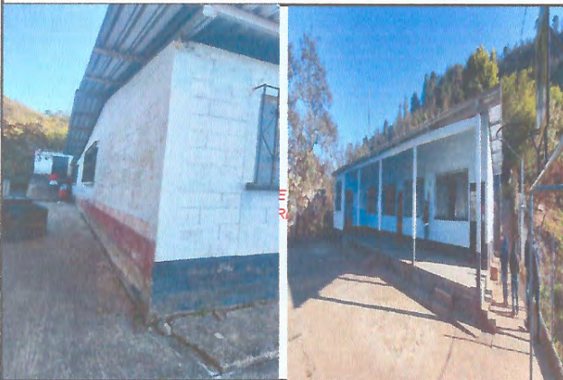
Foto 3: Necesidad de remozamiento en pintura del establecimiento.
